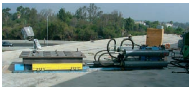
Rys. 6. Wibratory ustawione na dachu budynku [10]
